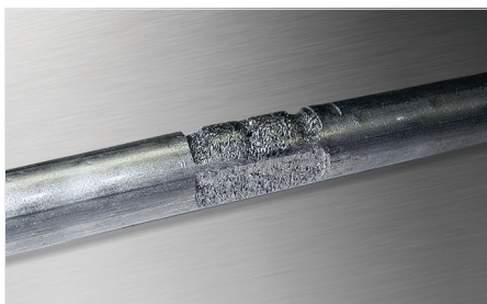
Spaltkorrosion unter einem üblichen Schellenkörper
